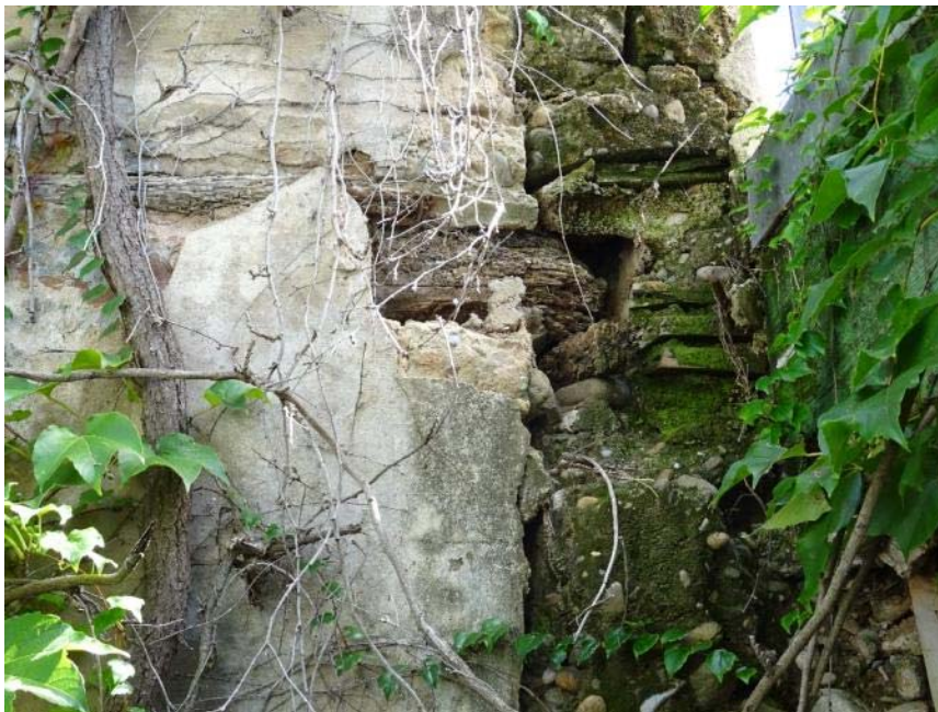
Detalle de viga de madera desprotegida en su encuentro con el muro de la fachada sur
