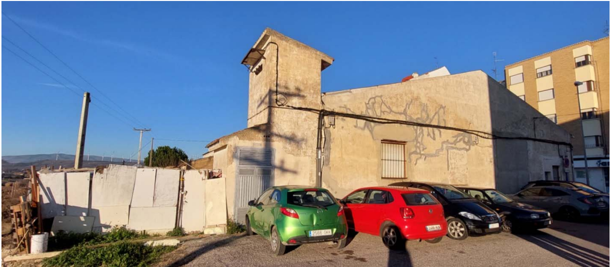
VISTA DE LA FACHADA ESTE, SE OBSERVA LA CONSTRUCCIÓN QUE ALBERGA EL TRANSFORMADOR.
