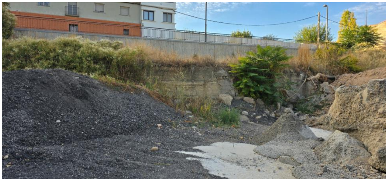
Muro de hormigón en mal estado en la zona norte de la parcela. El muro que se aprecia en el límite sur no pertenece a la parcela sino al vial con el que linda.
